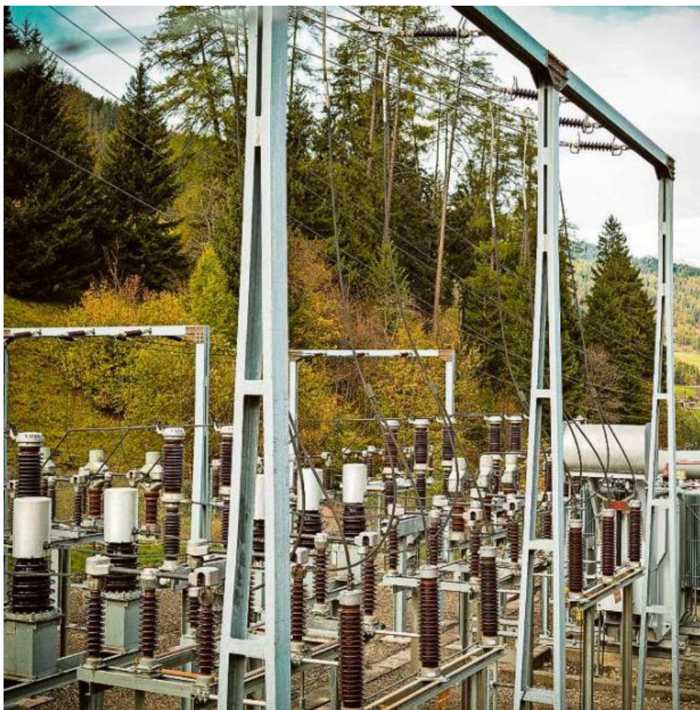
Das Unterwerk Parzutt wird derzeit auf den neuesten Stand der Technik gebracht, um die Versorgungssicherheit weiterhin zu gewährleisten. Bild Rabiosa Energie
