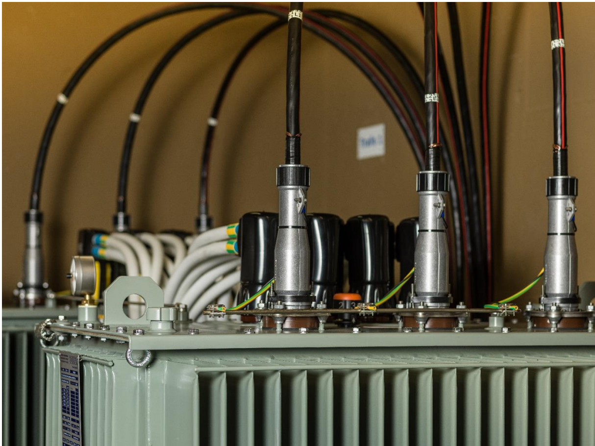
Anschlüsse vom Mittelspannungskabel am 1'000 kVA Transformier
