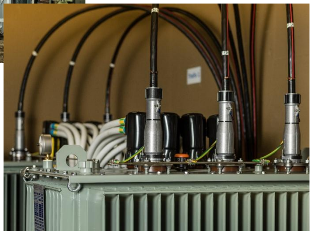
Anschlüsse Mittelspannungskabel am 1'000 kVA Transformer
