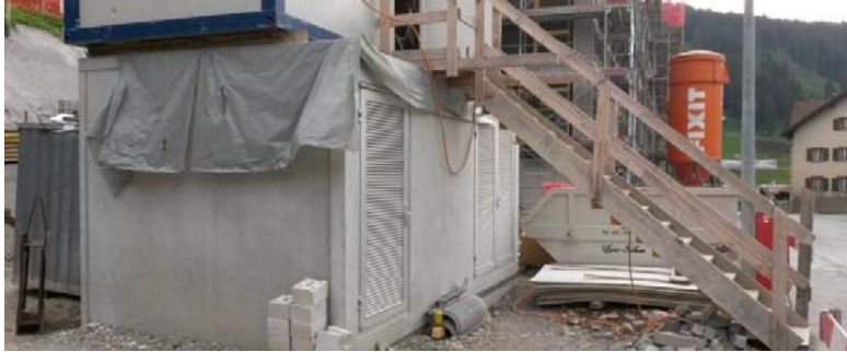
Trafostation Dorf gegenüber dem Dorfladen in Parpan
