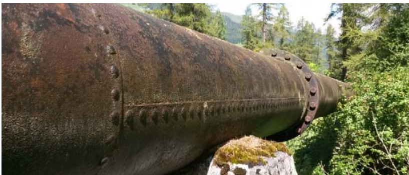
Druckleitung auf der Höhe in den Steinen – alte noch genietetete Druckleitung
