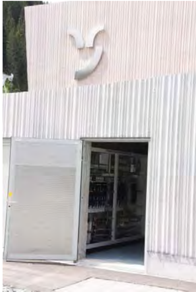
Trafostation im Gebäude Portal
