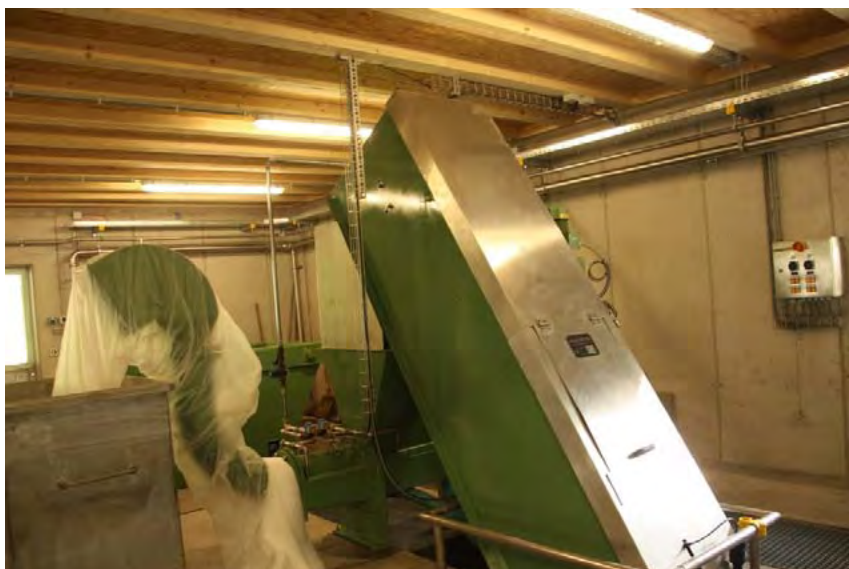
Rechen der mechanischen Vorreinigung in Parzutt
